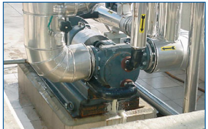
Pompe installée dans une usine de détergents Pomp gemonteerd in een installatie voor de productie van detergents Pumpe in einer Anlage für die Herstellung von Reinigungsmitteln
