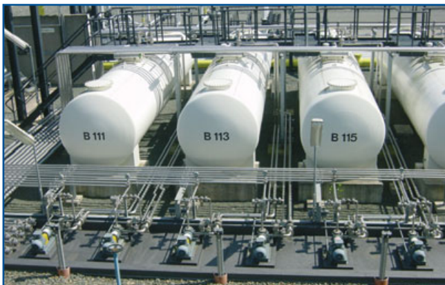
Pompage d'additifs pour huile lubrifiante en Allemagne Verpompen van additieven voor smeerolie in Duitsland Pumpen für Zusatzstoffe von Schmieröl in Deutschland
